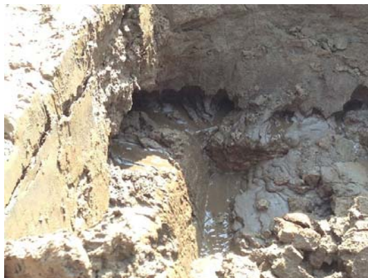
矢部川堤防決壊箇所付近 (R7.3 付近) の開削堤防断面からの地下水浸出状況
