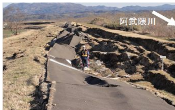
図 2.3.2 堤体の液状化（2011年東北地方太平洋沖地震・阿武隈川） 8)
