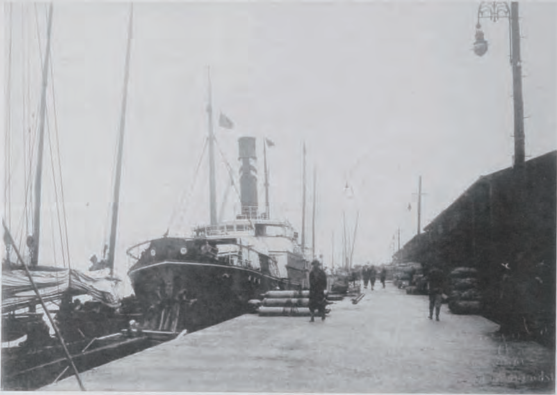
(23) 下關港修築工事東工區五米四岸壁 岸壁延長二百三十七米、前床混凝土幅八米 (昭和五年二月下關要塞司令部承認済)
