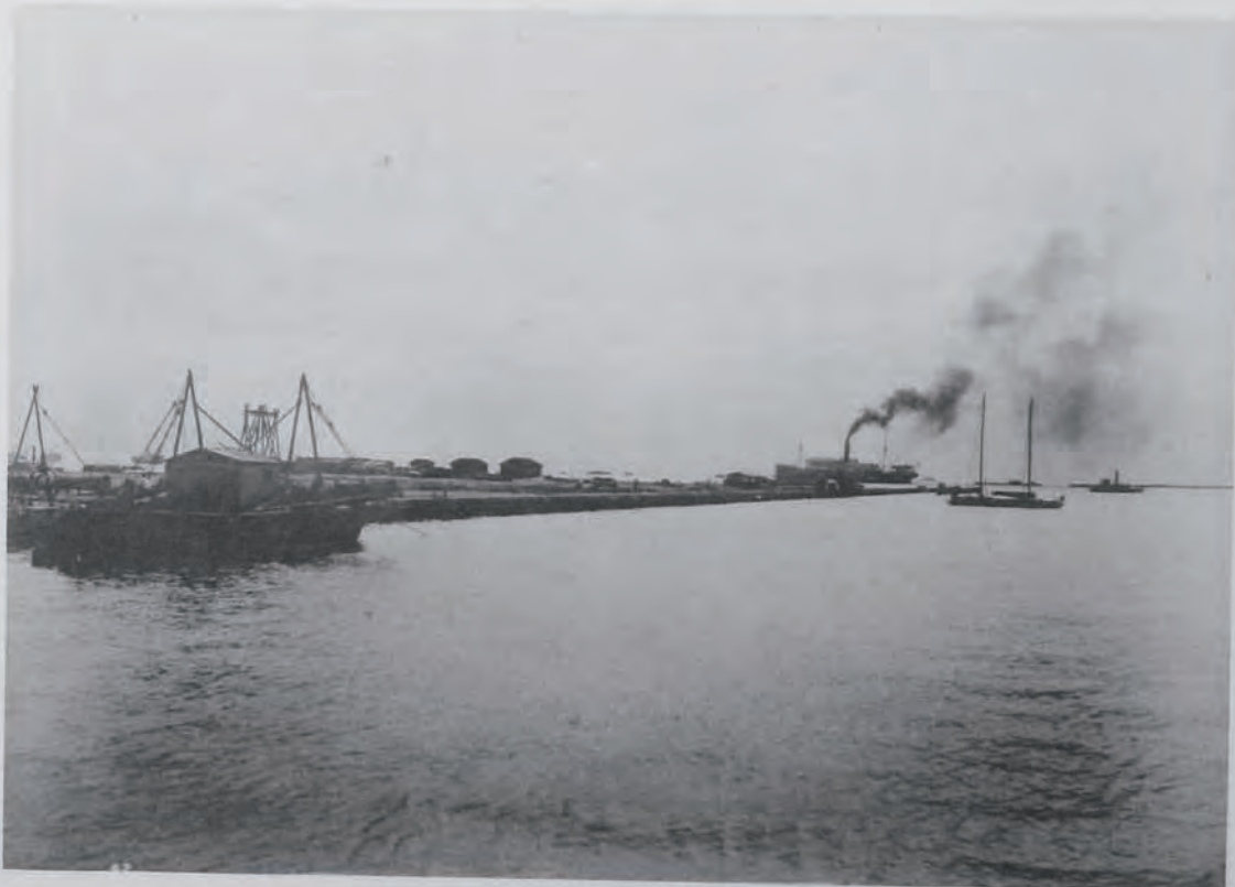
(20) 神戸港修築工事外國貿易設備第五突堤 沖合右岸ハ東防波堤ノ一ノ鐵筋混凝土函据付済ノ部分ニ シテ左方方塊疊積ハ同防波堤基礎工事施行中ノモノナリ
