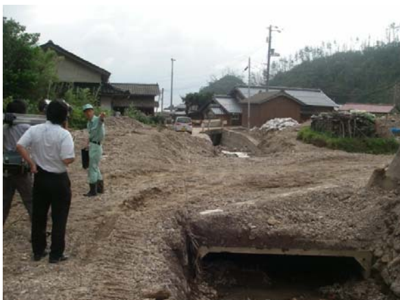
写真－３ 大津久川下流流路の埋塞 による土砂氾濫
