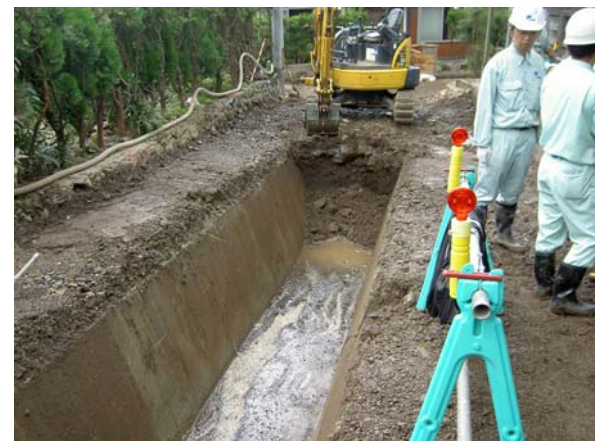
写真－１０ 赤ノ江谷の流末 暗渠水路が閉塞した
