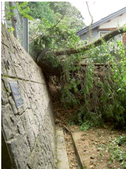
写真－３ 太一垣地区の急傾斜地の崩壊 崩土による防護柵の変形
