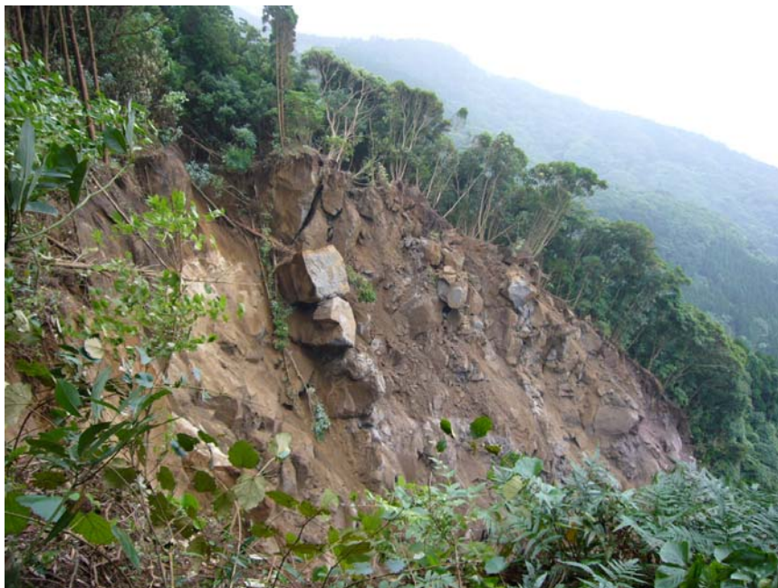
写真－２ 崩壊地左岸（平成 22 年 7 月 7 日午後撮影）
