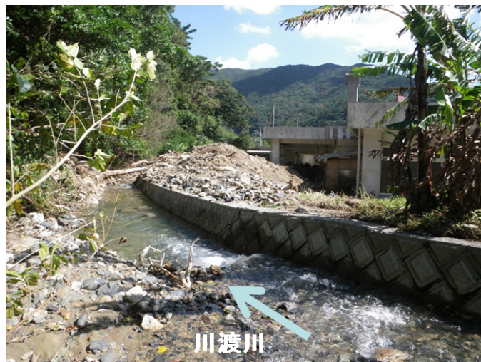
川渡川の河床上昇状況
