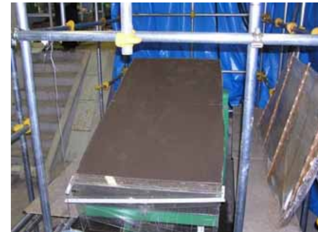
降灰斜面状況
