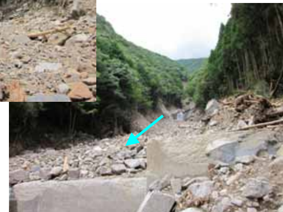
流下区間及び治山施設の破損状況
