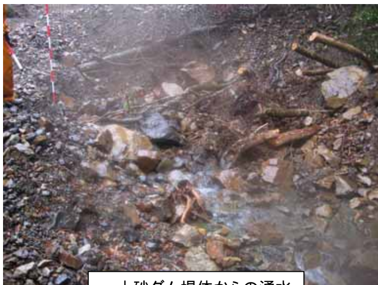
土砂ダム堤体からの湧水
