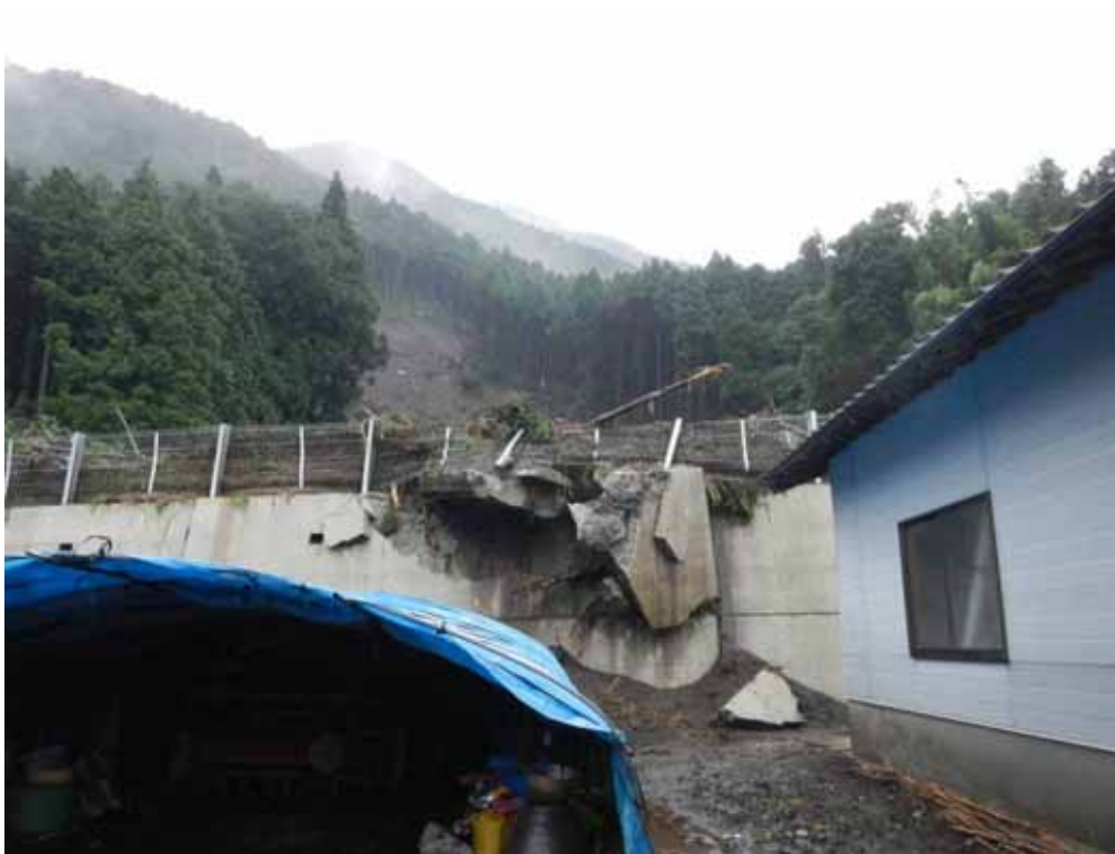
新所地区② 立野地区急傾斜地危険箇所に設置された重力式擁壁。上方で斜面崩壊が発生し、擁壁が一部損壊。
