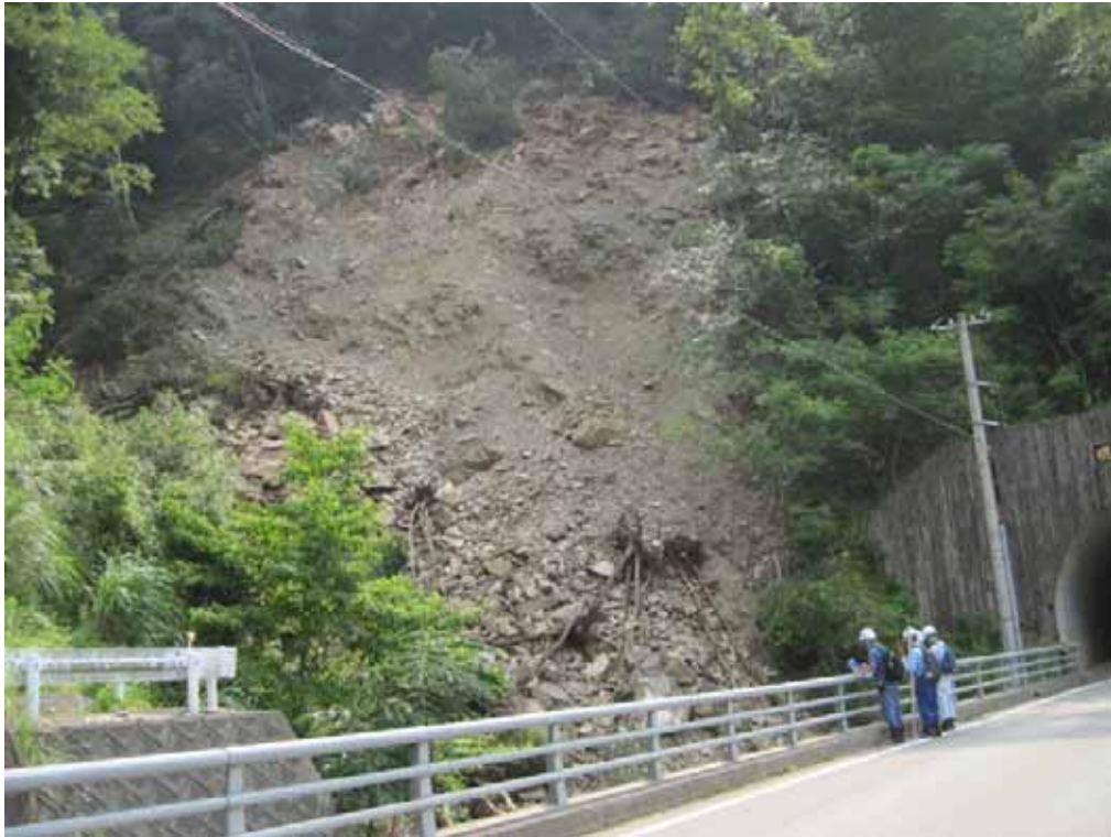
坑口側の表層崩壊
