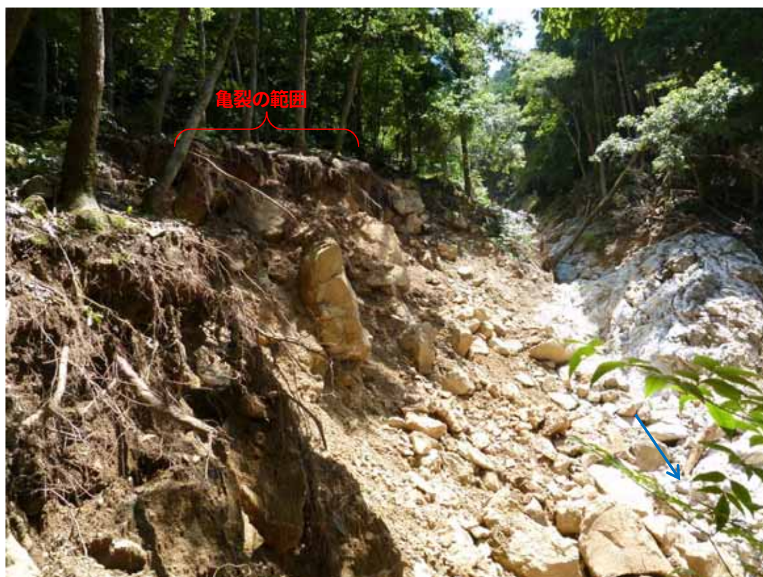
溪床の露岩と表土層
