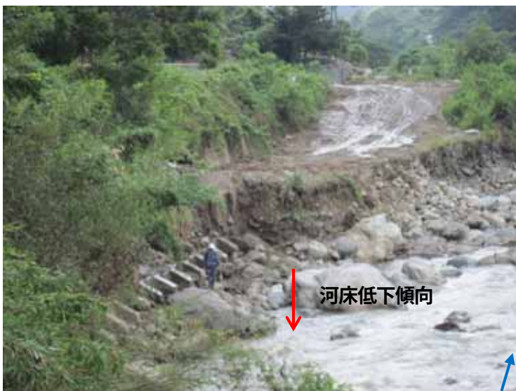
下流側根固めブロックの沈下状況
