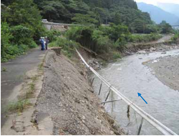
旧県道 25 号の決壊状況
