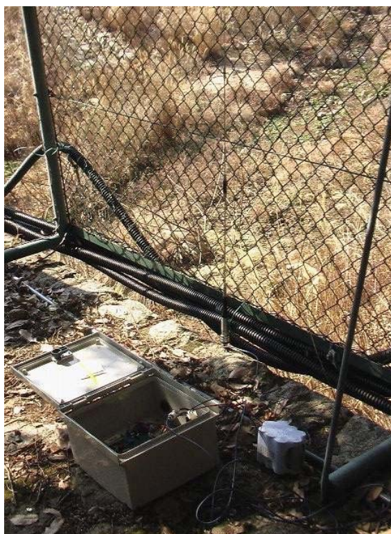
図－４ 受信制御装置（堰堤袖部）
