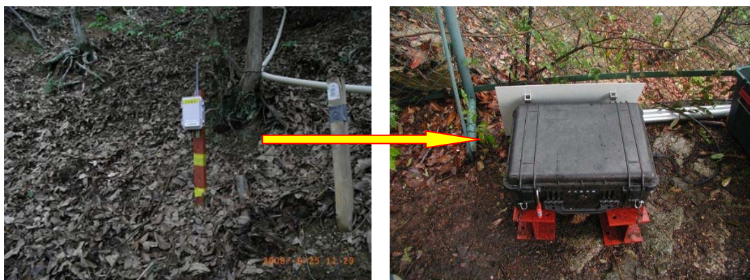
写真—1 タイプIVセンサー・無線受信 LINUX・KDDI モジュールの設置状況
