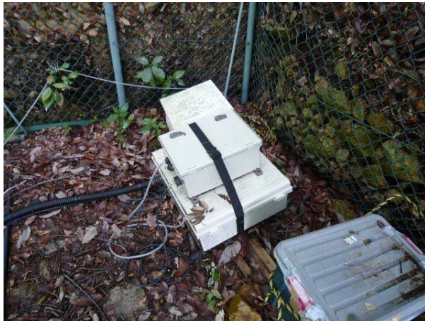
(a) 受信制御装置設置状況
