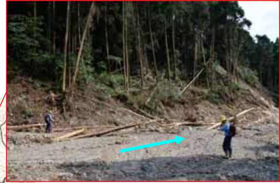
侵食により流木の発生が推定される溪岸と、その直下に堆積する流木
